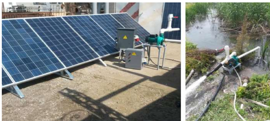
4.1-расм. Тошкент вилоятидаги қуёш энергияси ёрдамида ишлайдиган сув насоси
