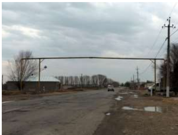
Газопровод над дорогой в Кумкурганском районе (1531 км)
