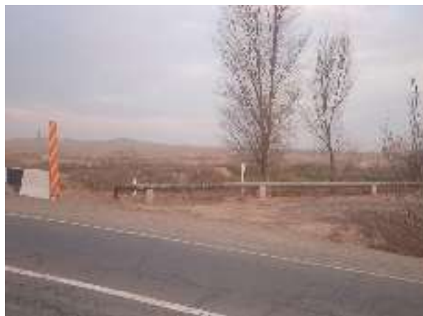
Подземные газопроводы в Термезском районе (1607 км)
