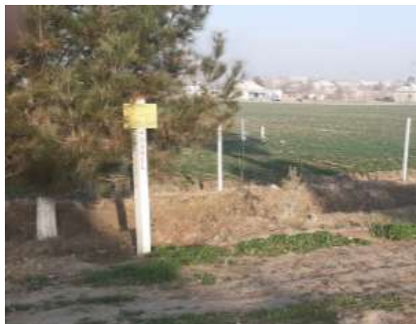
Существующие подземные кабели в Джаркурганском районе (1591–1598 км)
