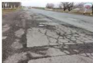
Qumqo'rg'on tumanidagi yo'l qoplamasida yoriqlar va chuqurchalar paydo bo'lgan.
