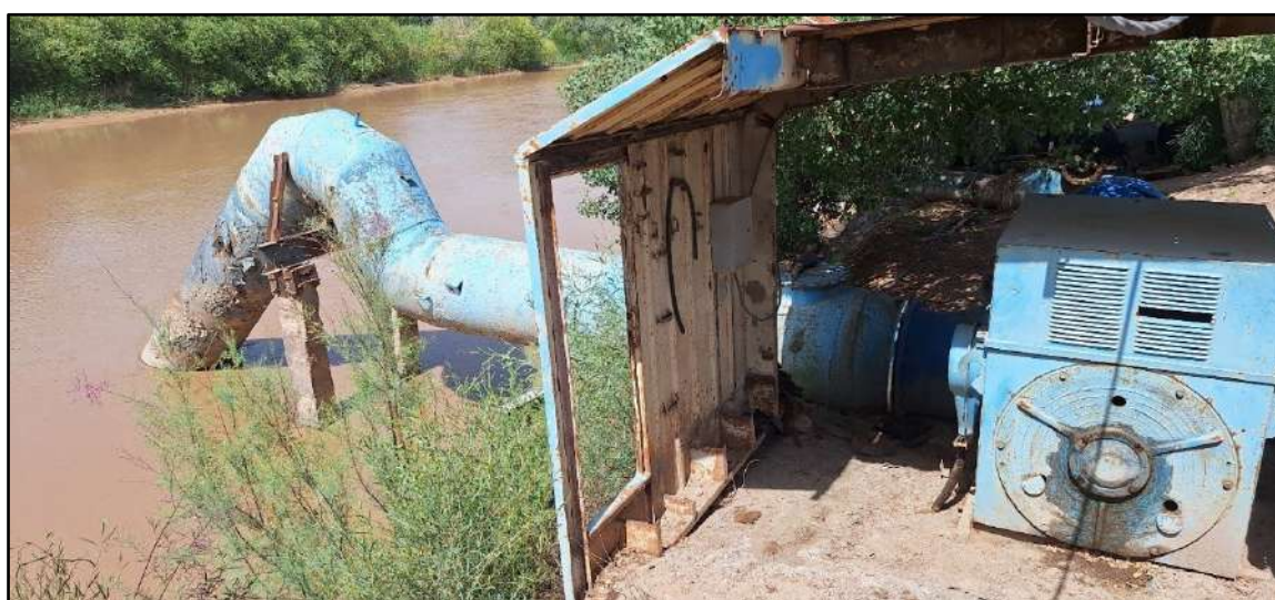
Рисунок 30. Водозаборные сооружения из магистрального канала Ташсака с устаревшей насосной станцией
