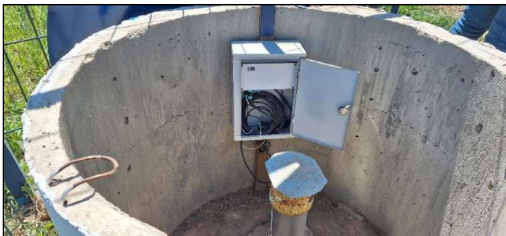
Рисунок 2. Наблюдательная скважина на грунтовые воды, оборудованная регистратором данных и телеметрическими приборами
