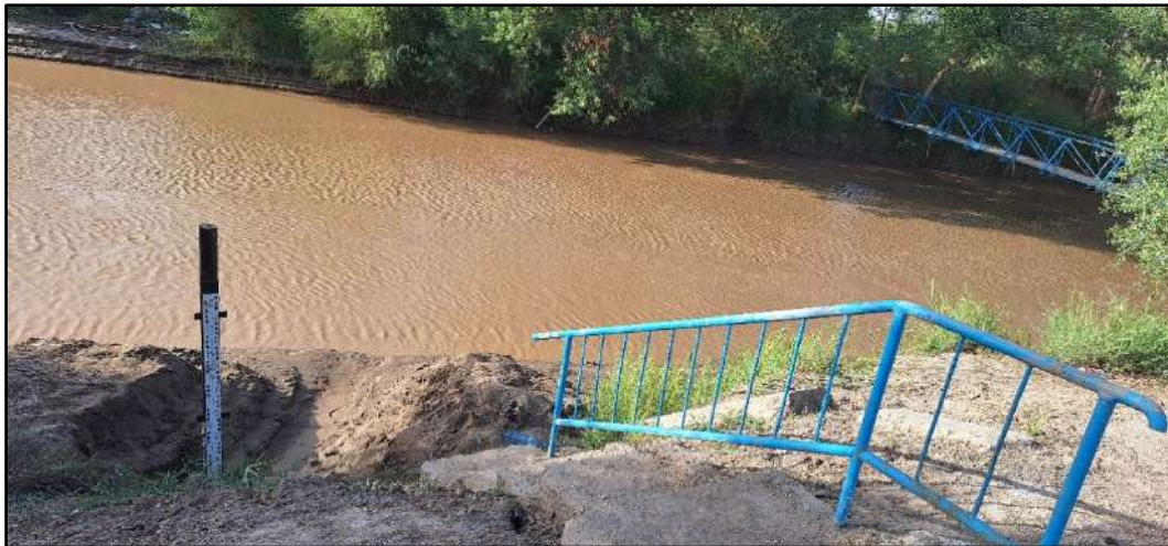
Рисунок 10. Наносы в земляном канале и изменение поперечного сечения канала в Хорезмской области
