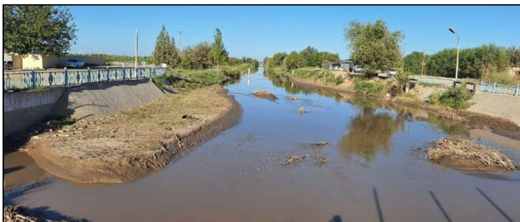
Рисунок 9. Наносы в земляном канале в Хорезмской области
