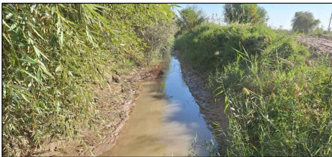
Рисунок 11. Растительность и проблемы эксплуатационного обслуживания в земляном канале в Хорезмской области
