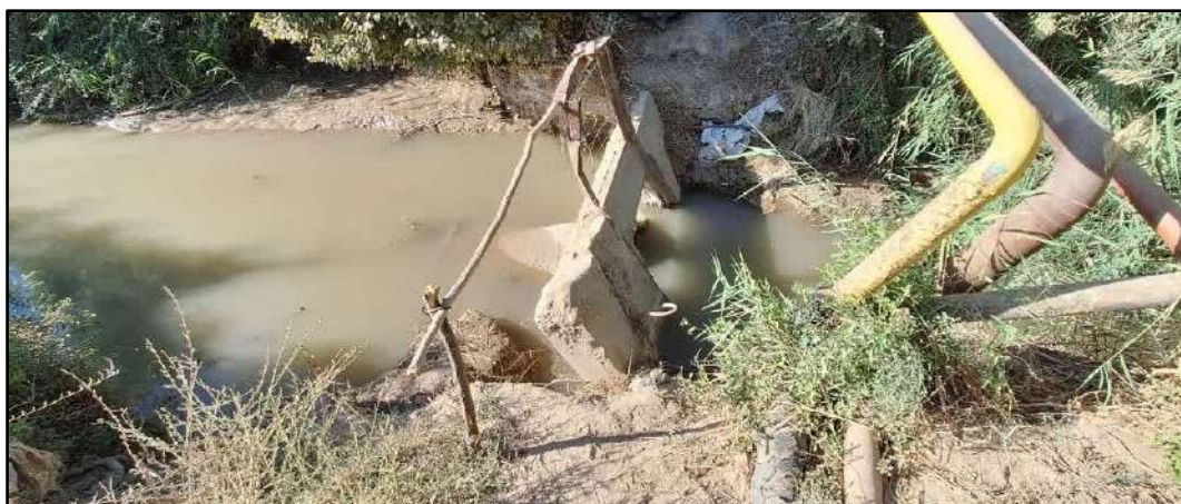
Рисунок 13. Устаревший затвор и гидротехническое сооружение в оросительной сети Ташсака
